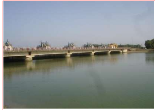
Barrage de garde Lalla Aïcha (Sebou)
