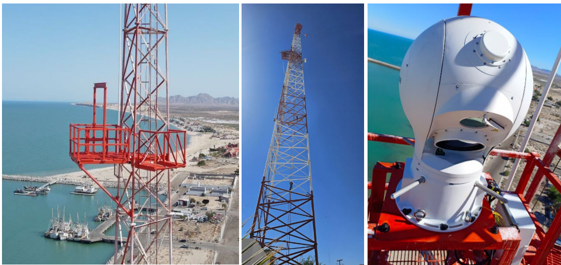
Imagen 3. Instalación del Sistema de Vigilancia de Largo Alcance (SIVILA) con cobertura de 25 km
